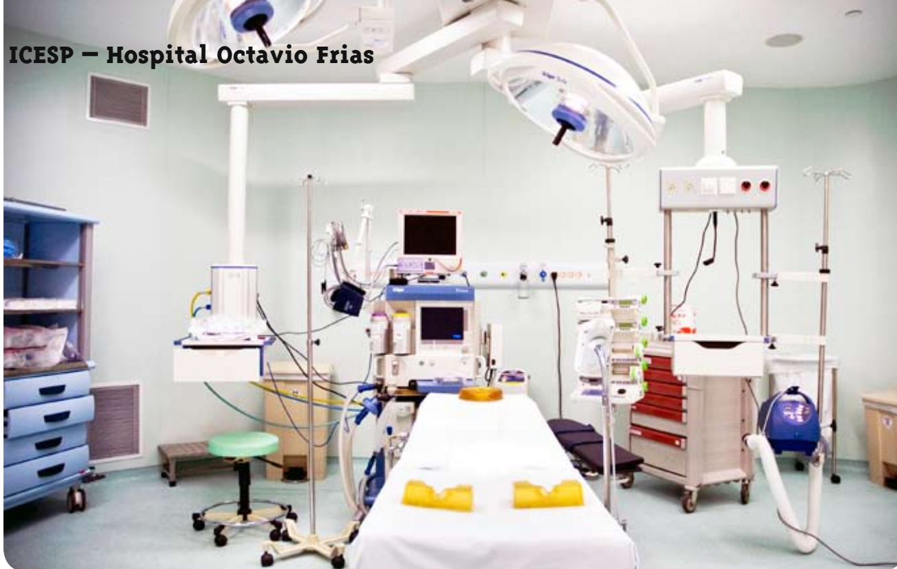
Dotado de equipamentos e controles de última geração, o centro cirúrgico possui sistema de tratamento de ar autônomo
