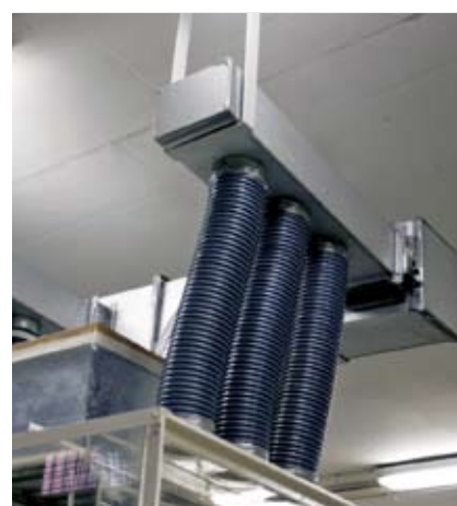
O projeto previa o uso de equipamento de insuflação e exaustão com três estágios de filtragem classes G4+F9+H14
