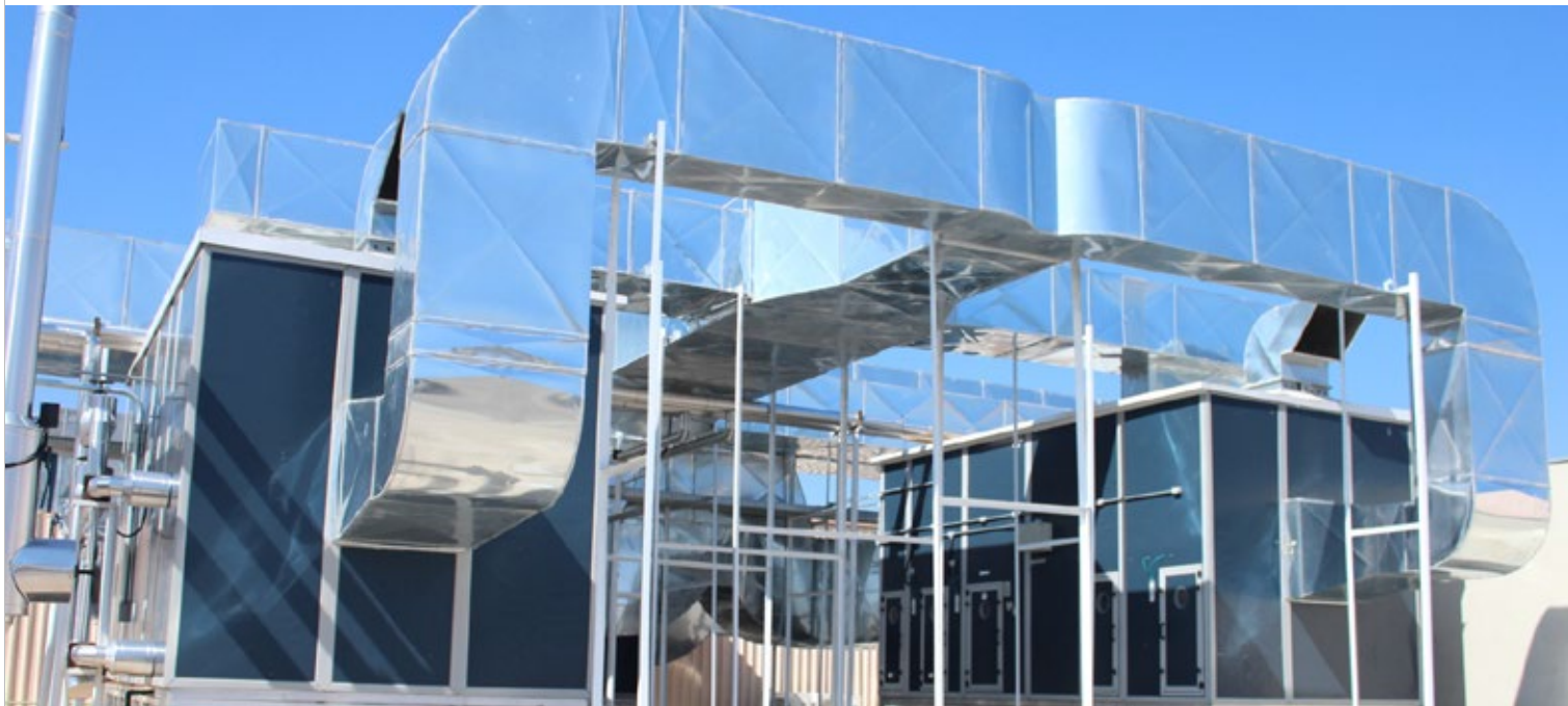
Unidade de tratamento de ar
